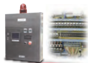
制御盤等ハード設計・製作
